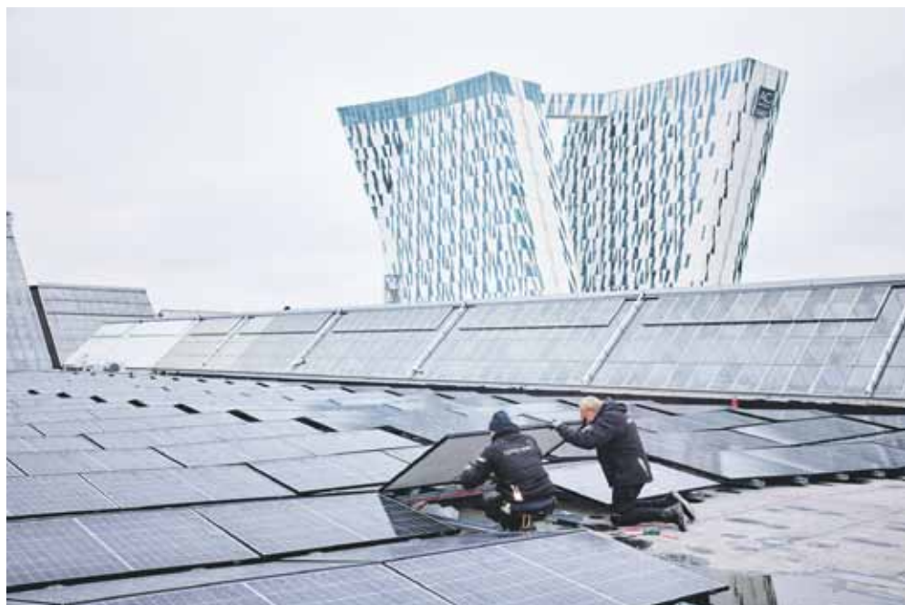
Et solcelleanlæg på størrelse med to fodboldbaner ser nu dagens lys på Bella Centrets tag. Solcelleanlægget bliver det største af sin slags på vores side af Storebælt. ”Det er helt oplagt at udnytte de mange flade tage i storbyerne til at skabe grøn energi, og der er ikke mange, der har så stort et tagareal som os”, siger Christian Folden Lund, der er administrerende direktør i Bellagroup. Solcellerne på taget kan fremover dække en tredjedel af centrets samlede strømforbrug. cmn
