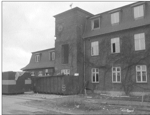
Så kom turen til 4K-bygningen. Bryggens mest særprægede hus bliver i disse dage revet ned. Mange havde håbet, at bygningen ville blive bevaret til enten offentlige eller private formål, eller simpelthen var blevet fredet.
