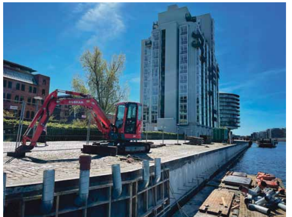
Store dele af bolværket langs Havnepark skal repareres. Millionregningen ender hos beboerne i området.
